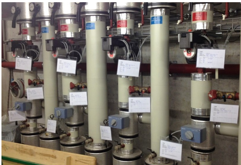
Beispiel eines Heizungsverteilers, mit beschrifteten Anlagekomponenten
